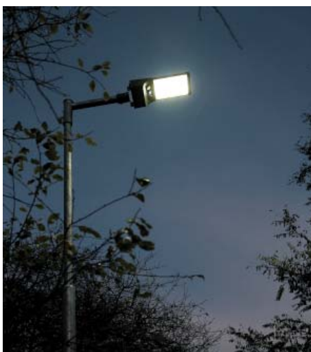
Osm svítidel iLED Solar bylo instalováno na vysočanské cyklostezce v blízkosti ulice Modrého koncem listopadu loňského roku
